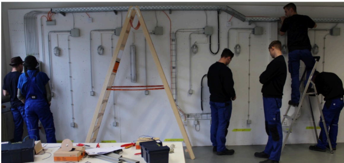
Wand mit den elektrotechnischen Installationen für ein Bürogebäude.
